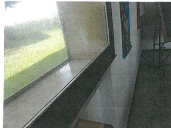
Particolare di un serramento tipo esistente
