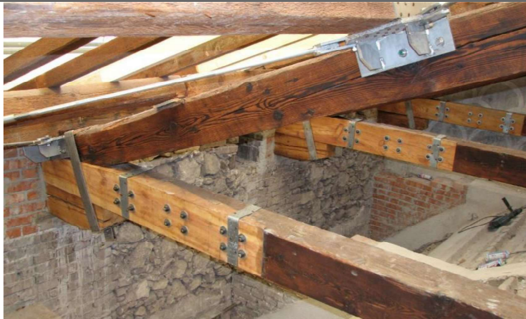
Particolare tipo protesi: esempio di sostituzione di testa di catena degradata con giunzione a “dardo di Giove” e fasciature metalliche
