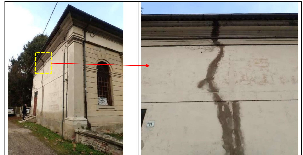
Particolari lesioni sulla testata Ovest
