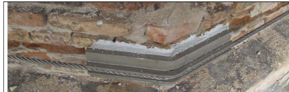
Esempio di cerchiatura esterna con funi inox inserita in posizione non visibile al di sopra di cornici
