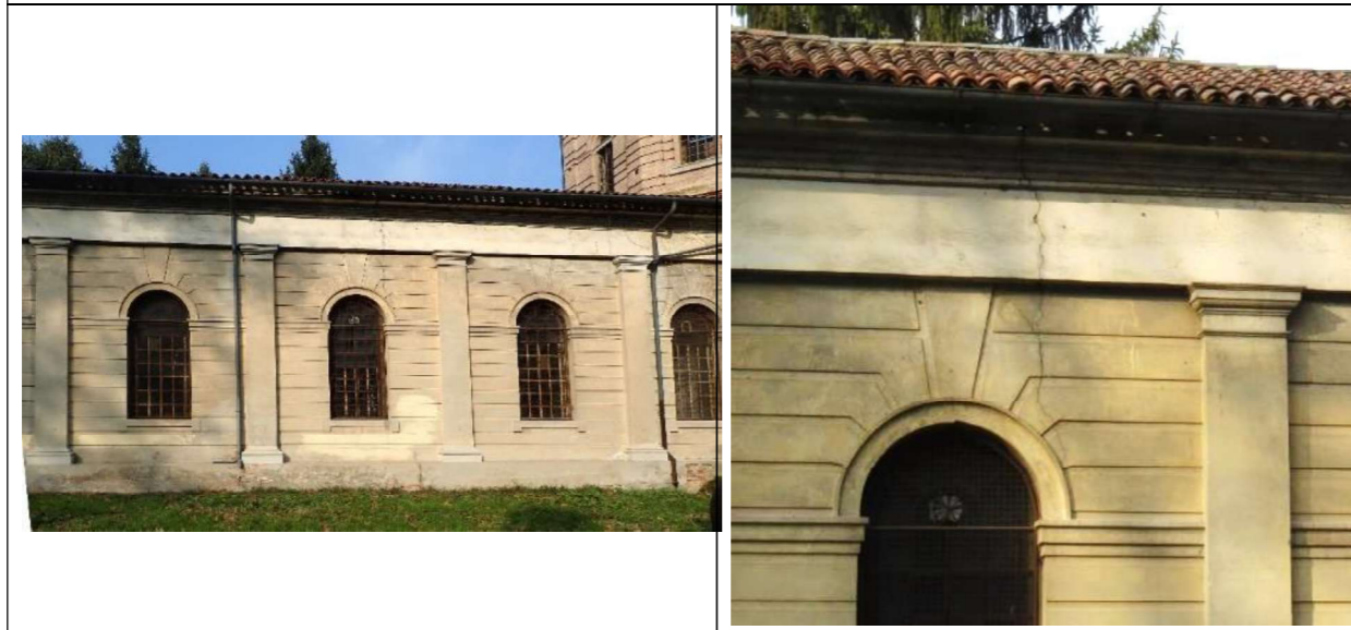
Particolare fessurazione nell'ala ovest legata alla presenza di murature realizzate in fasi successive
