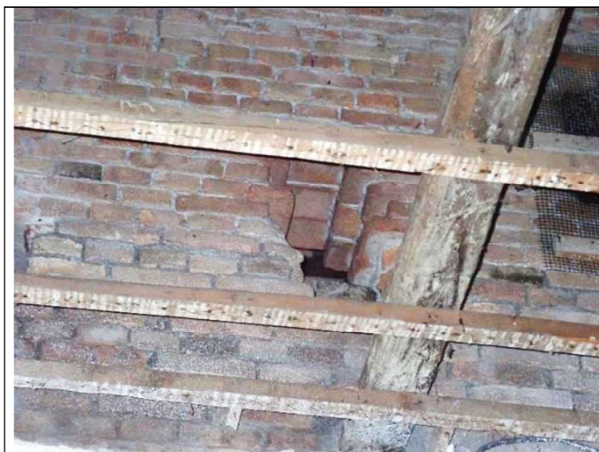
Particolare di un setto in muratura realizzato con mattoni pieni e spessore a tre teste
