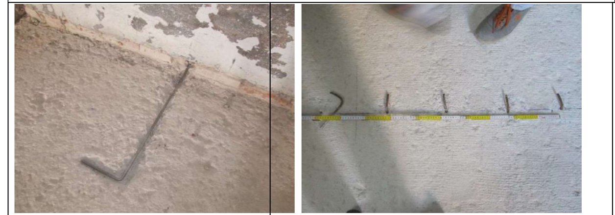
Particolari tipo degli ancoraggi perimetrali in acciaio inox inghisati nella muratura e dei connettori
